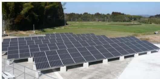
小型ソーラー発電施設
