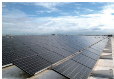
米国ベプシコ社ゲータレード工場に設置された太陽光発電システム
