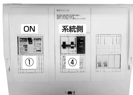
蓄電システム用分電盤
