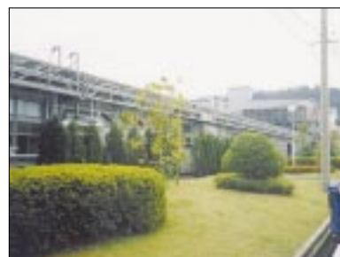
地下配管の架空化対策（鹿児島国分工場） 配管を架空化し、目視による点検が可能となっている。
