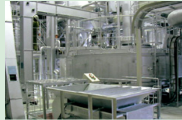
グリーンシート屑再資源化設備
