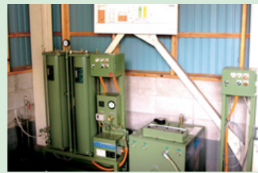
製品洗浄廃液処理装置
