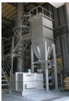
ダイオキシン対策用の活性炭吸着装置
