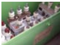
PCB廃棄物の保管状況
