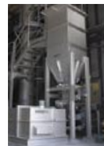
ダイオキシン対策用の活性炭吸着装置
