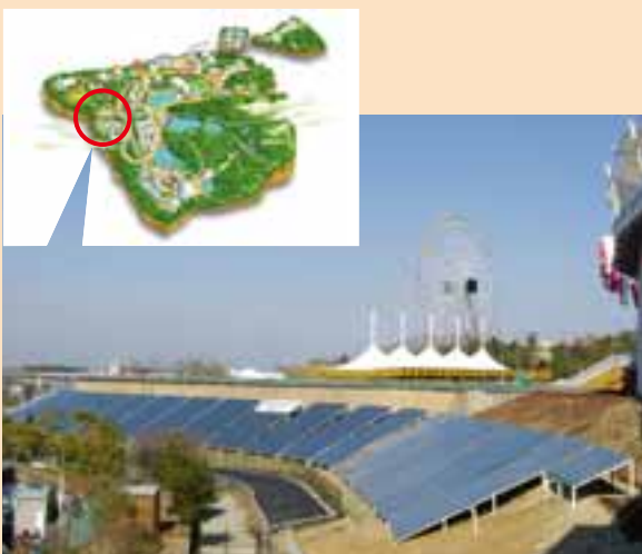
万博会場に設置された全長150mの京セラ製太陽電池モジュール
