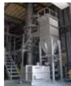
ダイオキシン対策用の活性炭吸着装置
