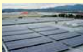
三重伊勢工場の設置事例
