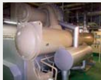
ターボ冷凍機
