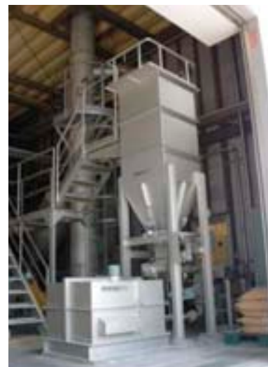
ダイオキシン対策用の活性炭吸着設備
