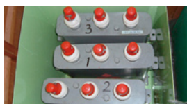
PCB保管ボックス (滋賀蒲生工場)
