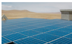
駅舎屋上の太陽電池パネル
