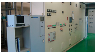
最終放流水の24時間連続 COD, シアン監視システム（滋賀蒲生工場）
