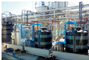
汚染地下水の化学処理設備
