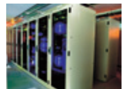
データセンター [京セラコミュニケーションシステム(株)]
