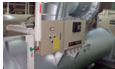
高効率ターボ冷凍機(鹿児島国分工場)
