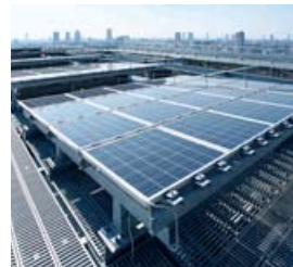
屋上に設置された太陽光発電システム
