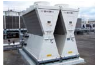
高効率ヒートポンプ (滋賀八日市場)
