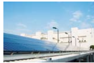
駐輪場の屋根上に設置された 太陽光発電システム
