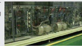
保護カバーが透明化された機械設備
