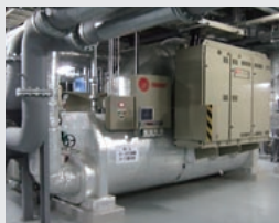
高効率熱源設備
