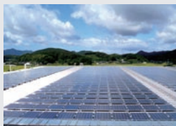
太陽光発電システム
