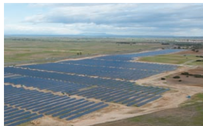
スペイン ドン・キホーテ太陽光発電所
