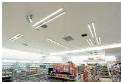
京セラのLED照明が採用されたコンビニエンスストア
