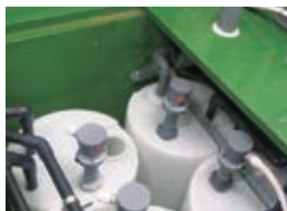
酸・アルカリ廃液タンク
