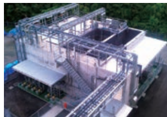
排水処理設備
