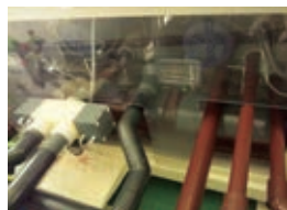
廃液移送配管
