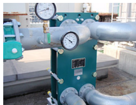
熱交換器 (滋賀野洲工場)
