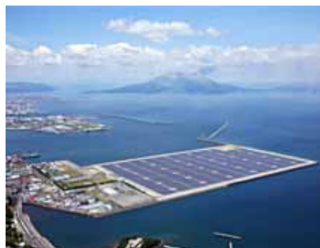
鹿児島七ツ島メガソーラー発電所
