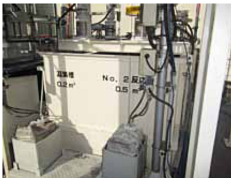
研削廃液処理設備
