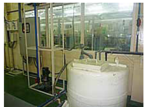
排水リサイクル設備
