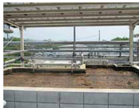
研削廃液曝気槽(好気性生物による有機物分解)
