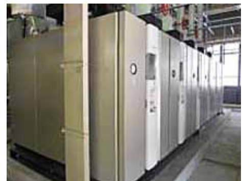
新たに導入したボイラー
