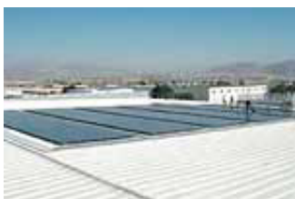
■ 京セラ(天津) 太陽エネルギー有限公司(中国) (93kW) (2010年度導入)
