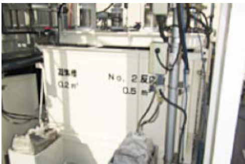
研削廃液の処理設備 (鹿児島川内工場)
