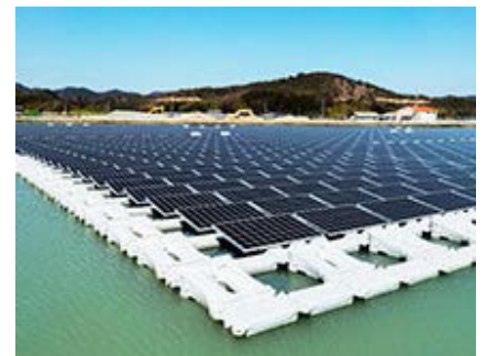
兵庫・高岡西水上メガソーラー発電所
