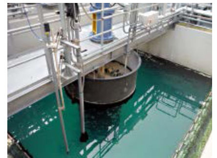
排水処理設備
