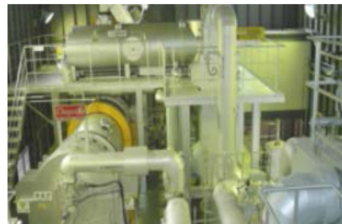
セラミック原料屑を焼結する熱処理設備 (鹿児島国分工場)
