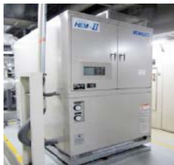
廃熱回収チラー
