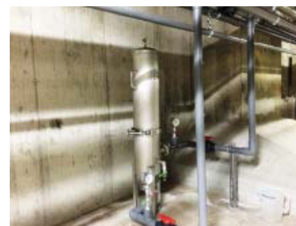
排水リサイクル設備
