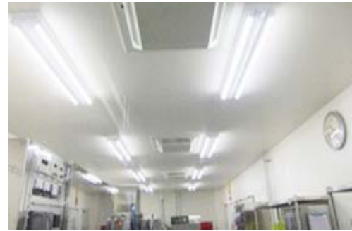
クリーンルームに導入したLED照明 (鹿児島隼人工場)
