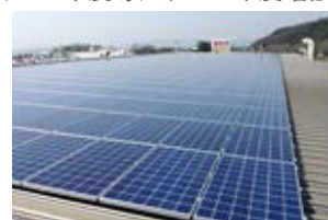
■ 滋賀蒲生工場 (491kW) (2010年度導入、2013年度増設)
