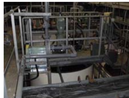
排水処理設備
