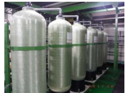
排水リサイクル設備
