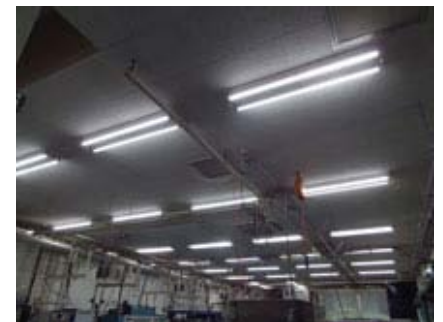
鹿児島国分工場に設置したLED照明
