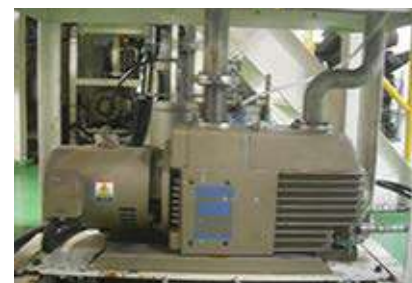
インバーターを導入した真空ポンプ
