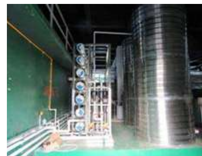
排水リサイクル設備
