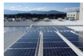
■ 長野岡谷工場(173kW) (2010年度導入、2013年度増設)
