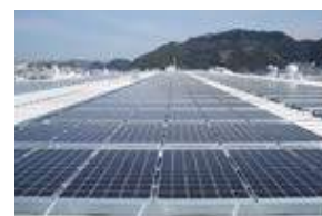
■ 鹿児島国分工場(1,100kW) (2005年度導入、2013年度増設)
