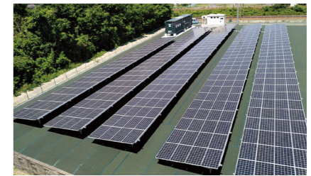
野洲上屋発電所 (太陽光発電システムと定置型リチウムイオン蓄電池)
