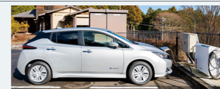
EV充放電機
