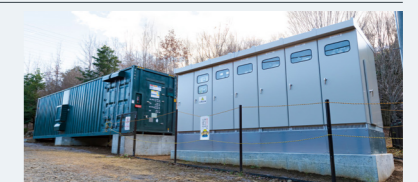
蓄電池、受変電設備、分散型サーバー設備
