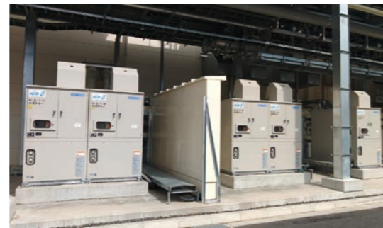
排熱回収チラー
