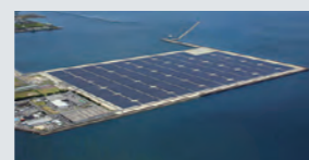
鹿児島七ツ島メガソーラー発電所
