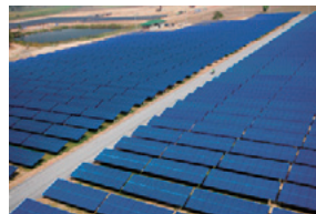
京セラ製の太陽電池が設置されたタイの太陽光発電施設
