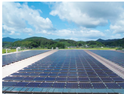
鹿児島川内工場の太陽光発電システム
