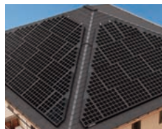
住宅用太陽光発電システム
