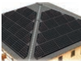
住宅用太陽光発電システム
