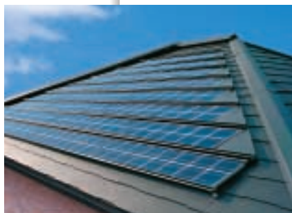
太陽光発電システム
