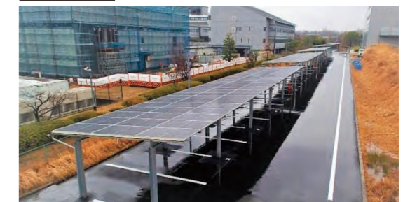
けいはんなリサーチセンターにおけるカーポットの設置
