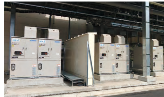
排熱回収チラー
