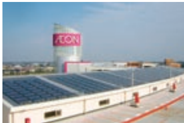
イオングループ36店舗* に京セラの太陽電池が設置されています。
