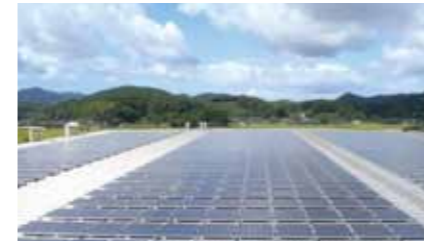
太陽光発電システムの設置 (鹿児島川内工場)
