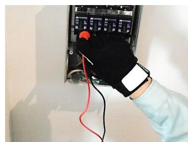
電気測定 （開放電圧・絶縁抵抗測定、バイパスダイオード検査）
