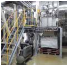
廃酸処理装置
