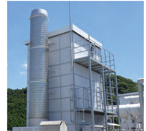
脱臭装置外観
