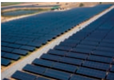
タイ・コラート市に設置された太陽光発電システム
