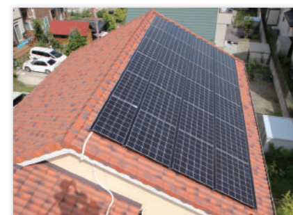
複合切妻屋根 / 洋瓦 エコノルーツ モジュール枚数: 24枚 (4.38kWシステム)
