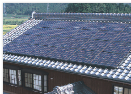
切妻屋根 / 和瓦 エコノルーツ モジュール枚数: 24枚 (4.32kWシステム)
