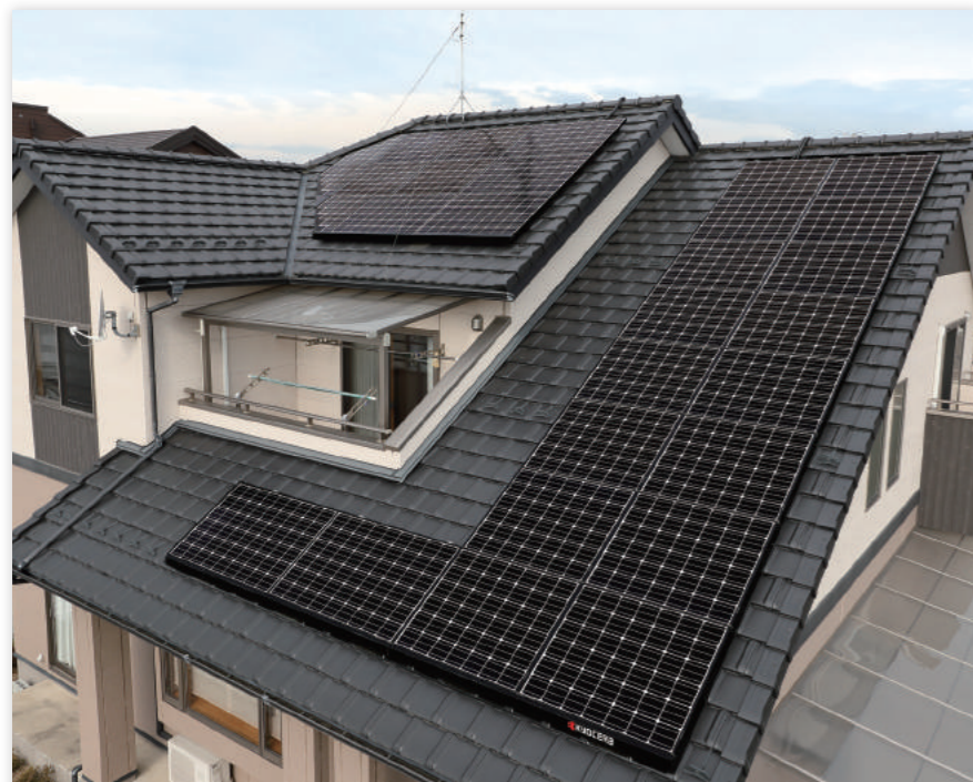
複合寄棟屋根 / 平板瓦 ルーフレックス モジュール枚数: 29枚 (5.83kWシステム)
