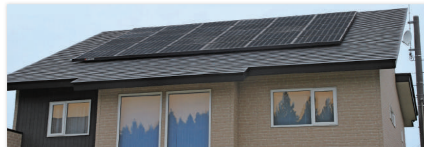
切妻屋根 / 横葺き板金 多雪地域専用システム モジュール枚数: 30枚 (6.30kWシステム)
