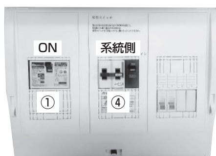
蓄電システム用分電盤
