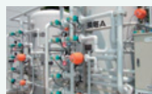
鉛排水リサイクル設備(イオン交換塔)
