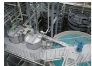
排水処理設備（滋賀八日市工場）
