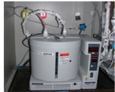
配管誤接続が対策された設備
