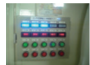
空調機の手元操作盤
