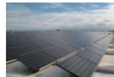
太陽光発電システム
