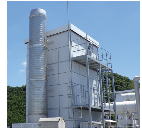
脱臭装置外観
